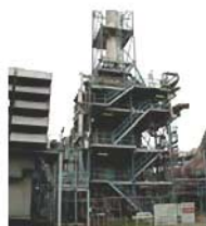
ボイラー廃熱回収装置
