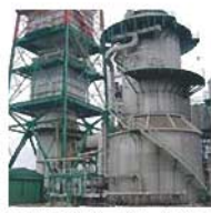
蒸気硫黄回収装置及びH 2 S回収装置
