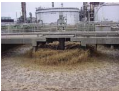
※1活性汚泥処理設備
