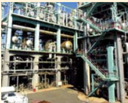
川崎製造所のエチレン製造装置
