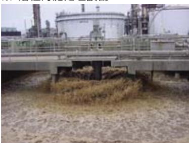
※1 活性汚泥処理設備
