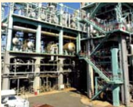
川崎製造所のエチレン製造装置
