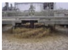
※1 活性汚泥処理設備
