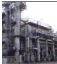
硫黄回収排煙脱硫装置
