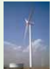
風力発電設備
