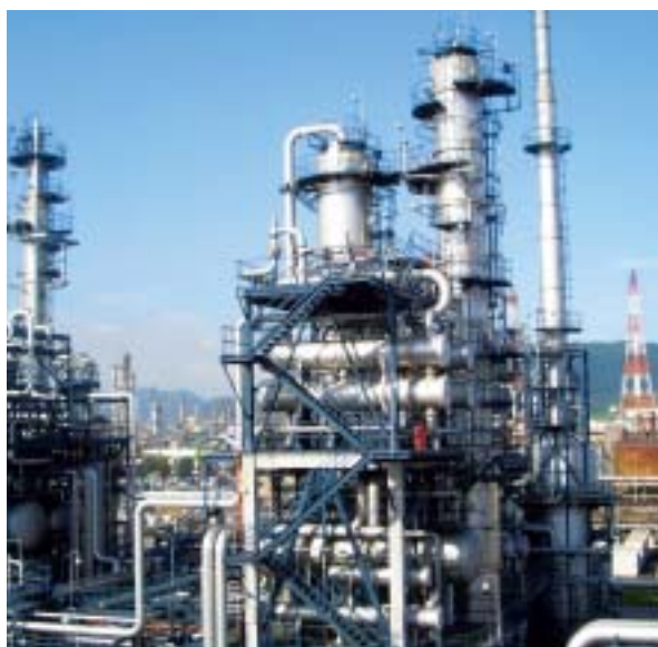
サルファーフリーガソリン製造設備
