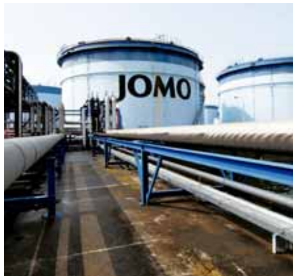
京浜油槽所の貯蔵タンクとパイプライン
