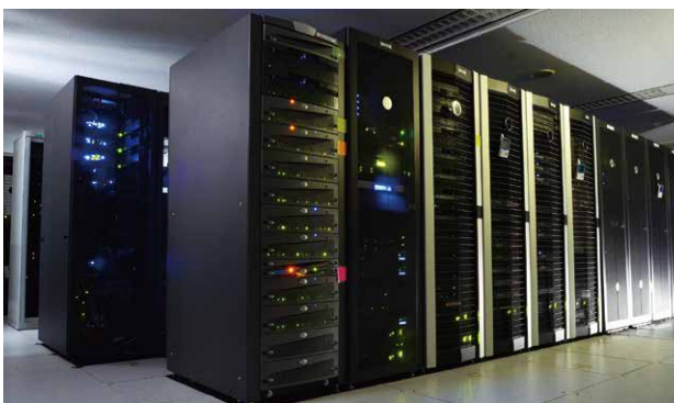
サーバールーム
