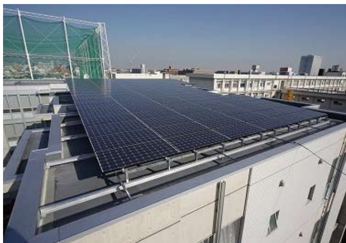
新城社宅へ設置した太陽光発電パネル
