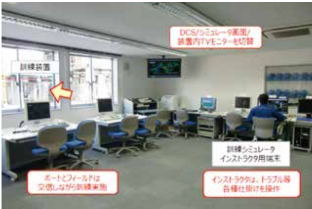
図 6 計器室内設備・配置
