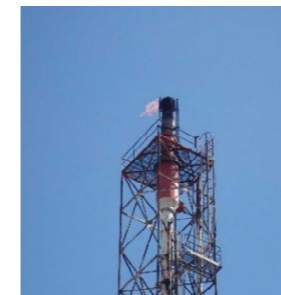
フレアスタック
