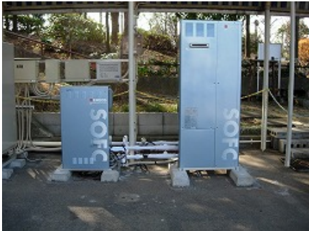
LPG仕様の設置写真
