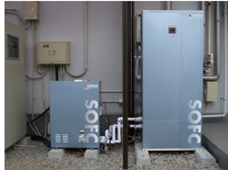
LPG仕様の設置写真
